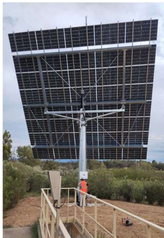
Pose d'un tracker à la station d'épuration de Pollestres.
