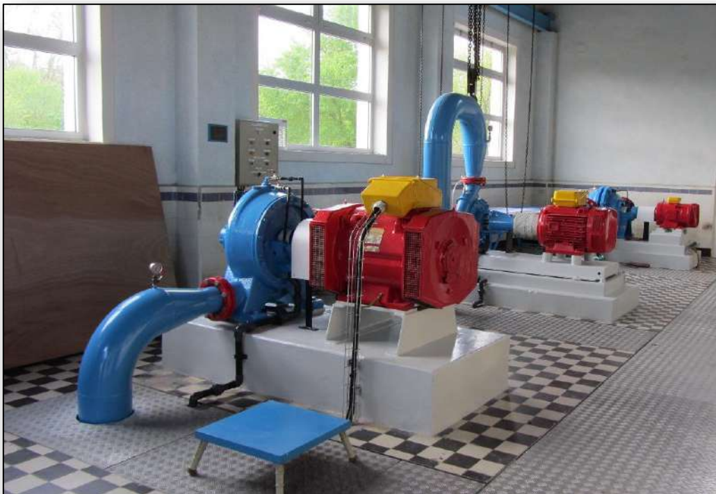
Station de pompage de Fraise
